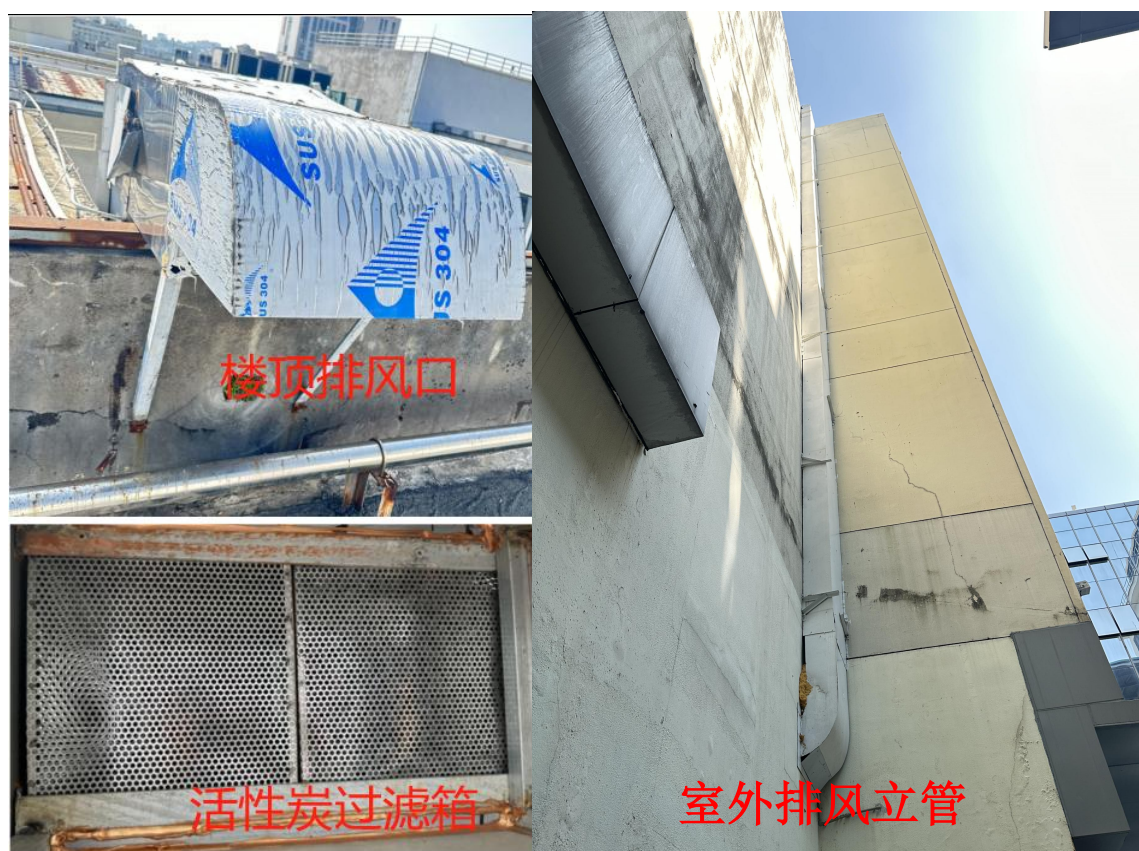
图 3-12 排风管道现场照片
