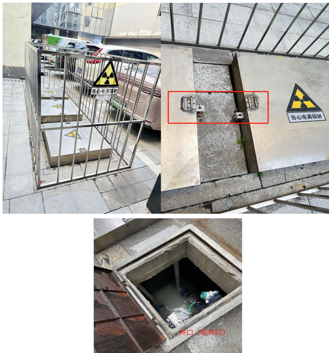
图 3-8 衰变池、不锈钢围栏、警示语句和电离辐射警示标志、井盖上锁、井口
